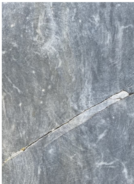
Durchgehender Riss im Podest
